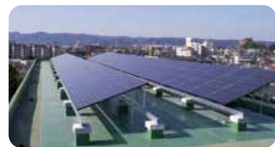
市有施設の太陽光発電システム
